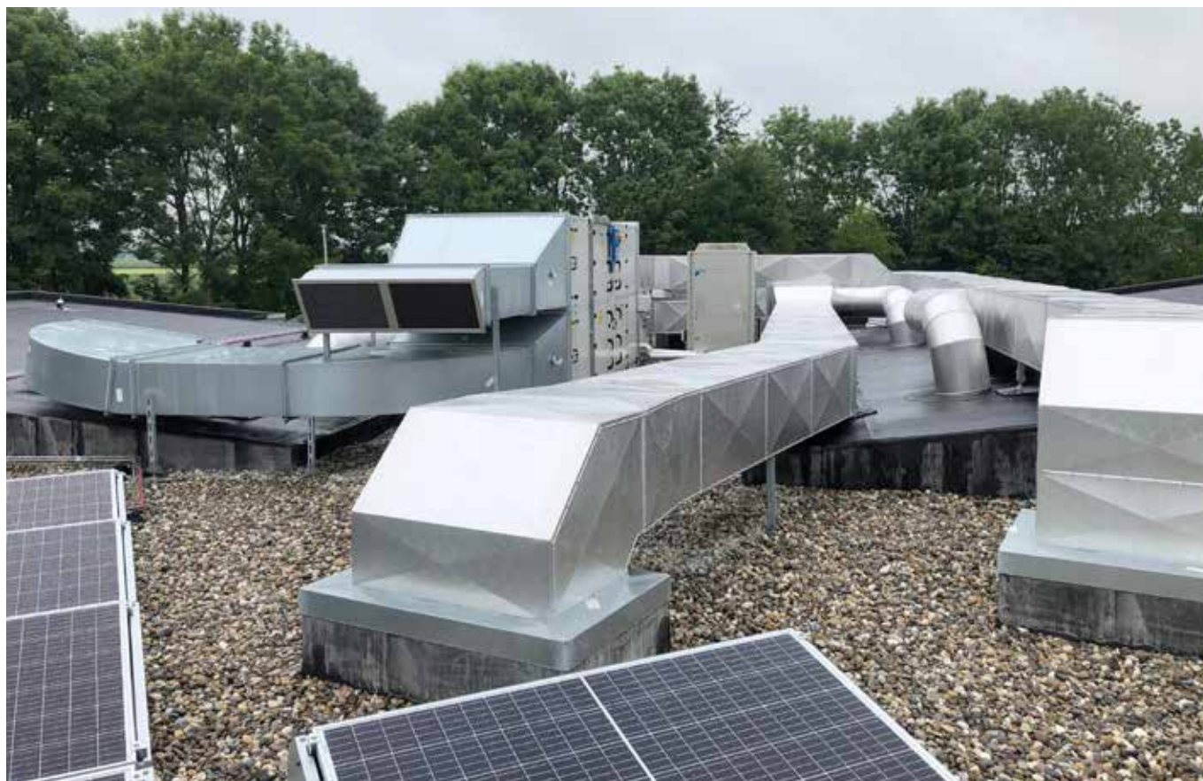
Luchtbehandelingskast en kanalenwerk op het dak.
