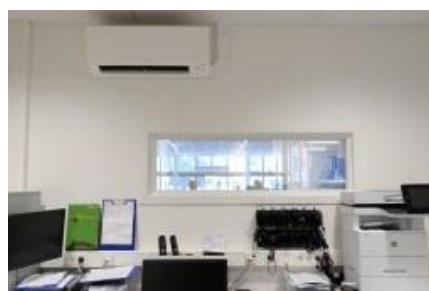
Hangende units bieden comfort het hele jaar door
