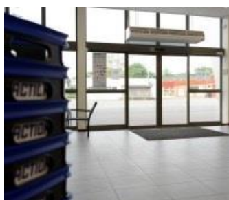
Het luchtgordijn op de deur is verbonden met een warmtepomp voor maximale efficiëntie
