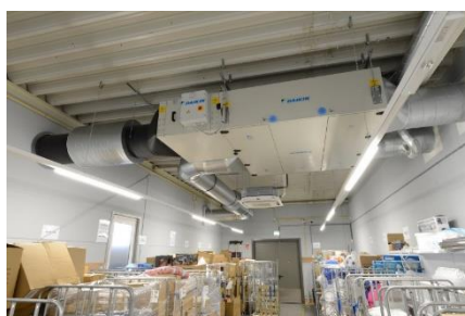
Het Modular L ventilatiesysteem in de opslagruimte zorgt voor ventilatie in de winkel
